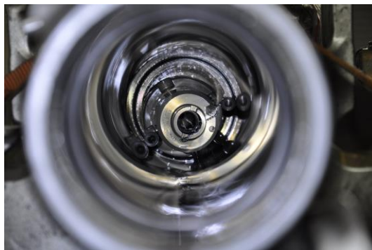
Foto 13: osservazione visiva della sede della valvola, del pistone e dei cilindri di fissaggio.
