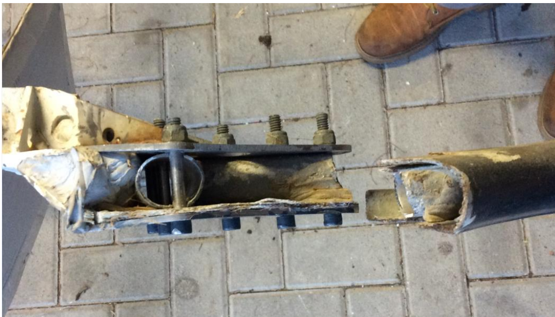
Foto 36: punto di rottura della struttura alla quale è vincolata l'asta di controventatura. Si noti l'ovalizzazione del tubolare.
