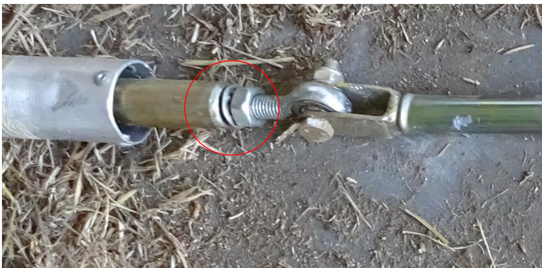
Foto 8: terminale dell'asta di un comando di volo con dado di bloccaggio allentato.
