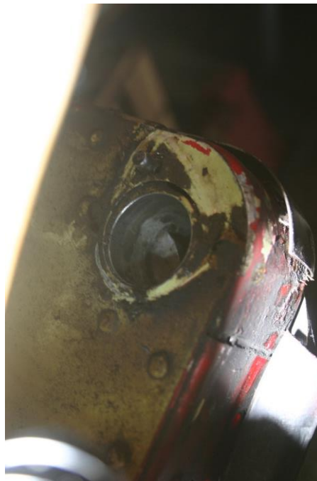
Foto 9: il punto di fissaggio del cilindro di sblocco in emergenza con la ghigliottina di blocco/sblocco.
