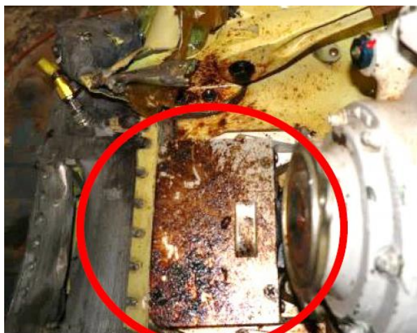
Foto 17: supporto isolante, schizzi di grasso provenienti dal giunto e nessuna traccia di rotazione sul supporto (cerchio).
