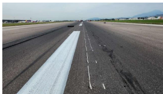
Foto 5: danni alla pista (Fonte SACBO).
