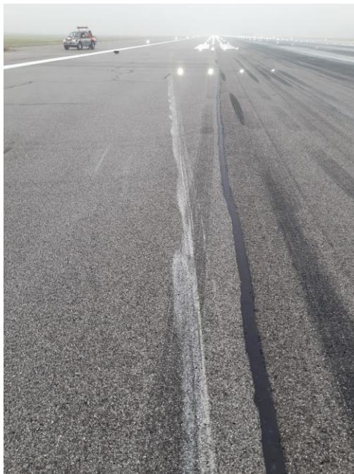
Foto 5: tracce presenti sulla pista.
