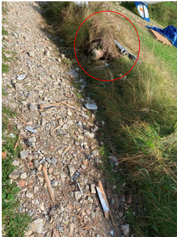
Foto 2: muretto in pietra danneggiato e frammenti di pala.
